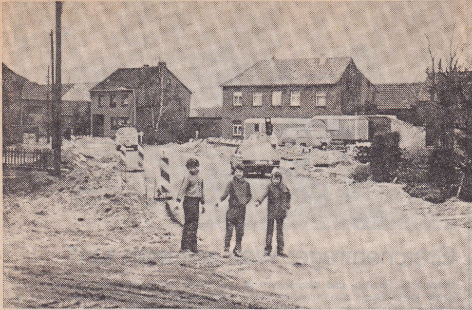
Noch sieht es hier ziemlich wüst aus: Die Ortsdurchfahrt Süggerath wird schon seit einigen Monaten ausgebaut. Demnächst ist auch Süggerath an der Reihe. Fertigstellungstermin für beide Maßnahmen soll Ende 1980 sein. (Foto: Horst-Uwe Münchs)
